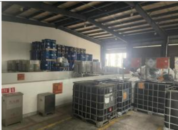
危废间地面已进行防腐，设置通风收集装置、收集沟
