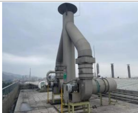
SM1 车间排气筒（FQ-223-3）
