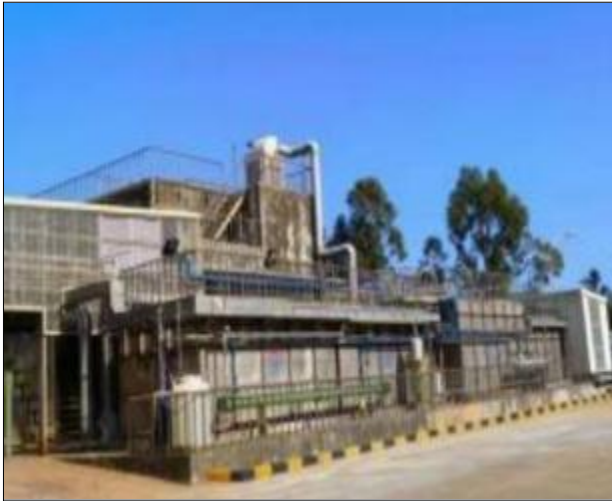
废水处理系统
