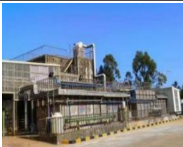
废水处理系统
