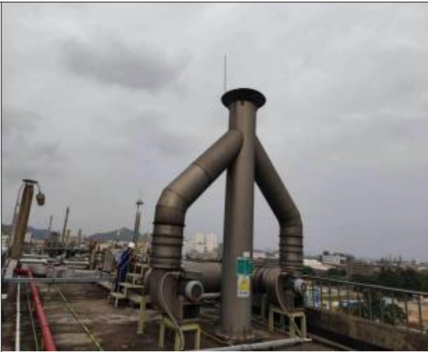
SM2 车间排气筒 (FQ-223-5)
