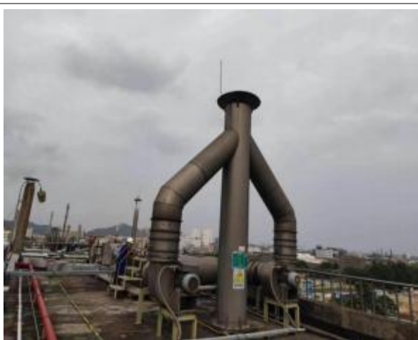
SM2 车间排气筒（FQ-223-5）
